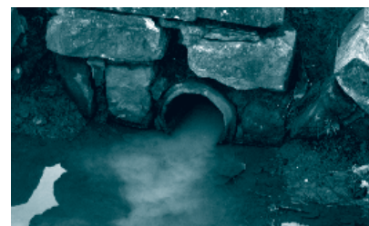
Rejet direct d'eau usée au cours d'eau • Photo CCBW
