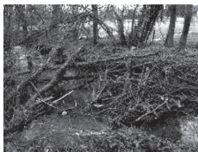
Entrave à l'écoulement • Photo CCBW
